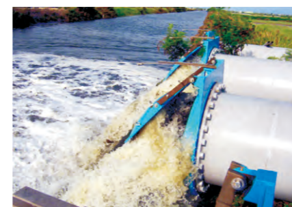
低窪地區抽水站 Pump station for low level surface
